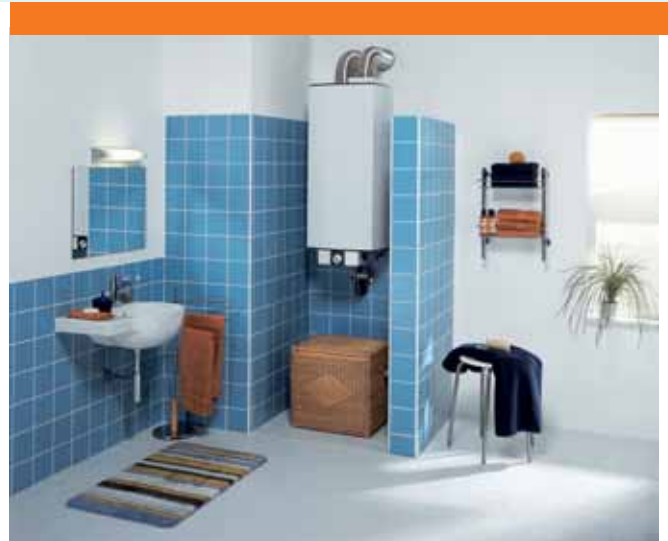
Abluftanlage in Kombination mit WW-Speicher Foto: tecalor
